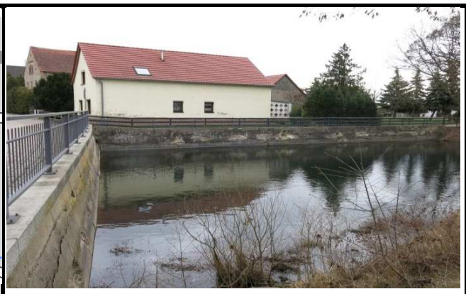
marode Stirnwände am Feuerlöschteich
